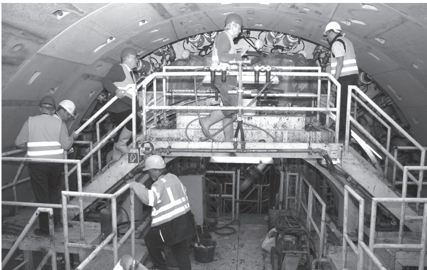
Der Vorstand informierte sich nicht nur über die planerischen Aspekte, sondern auch über den Baufortschritt vor Ort.
